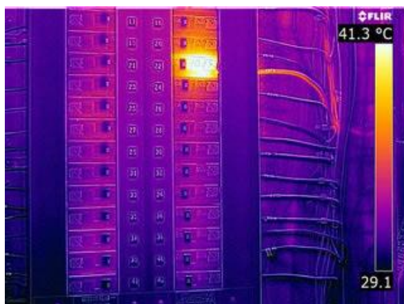
Painel Elétrico com cabos expostos
