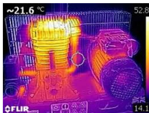
Compressor de sistema de Refrigeração
