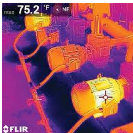
Bomba água em operação
